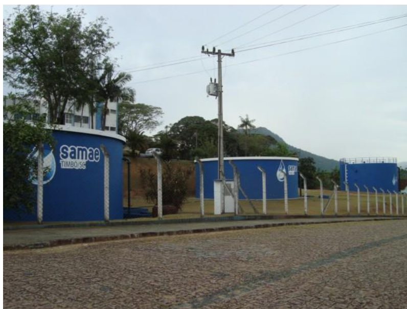
Foto 38 – Conj. de Reservatórios junto à ETA
