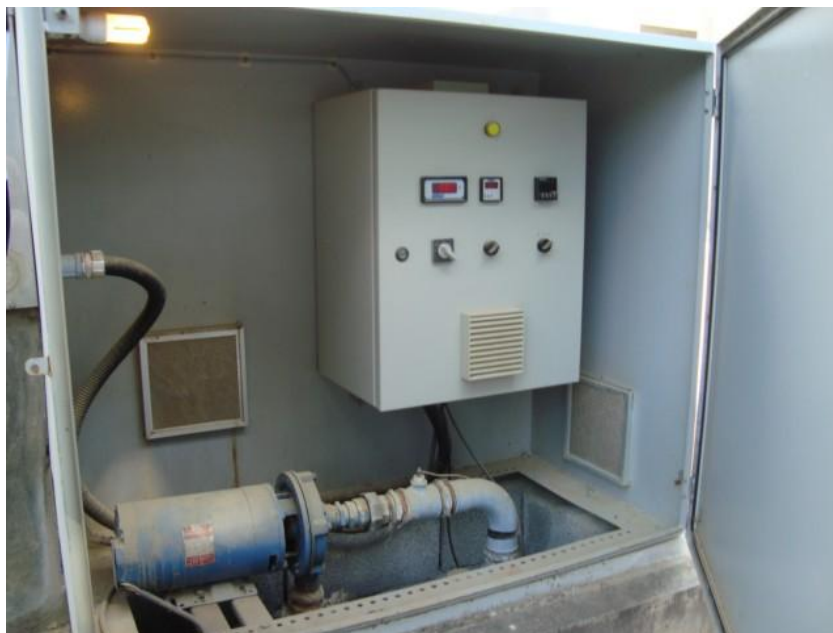
Foto 36 - Booster Rua Piauí
