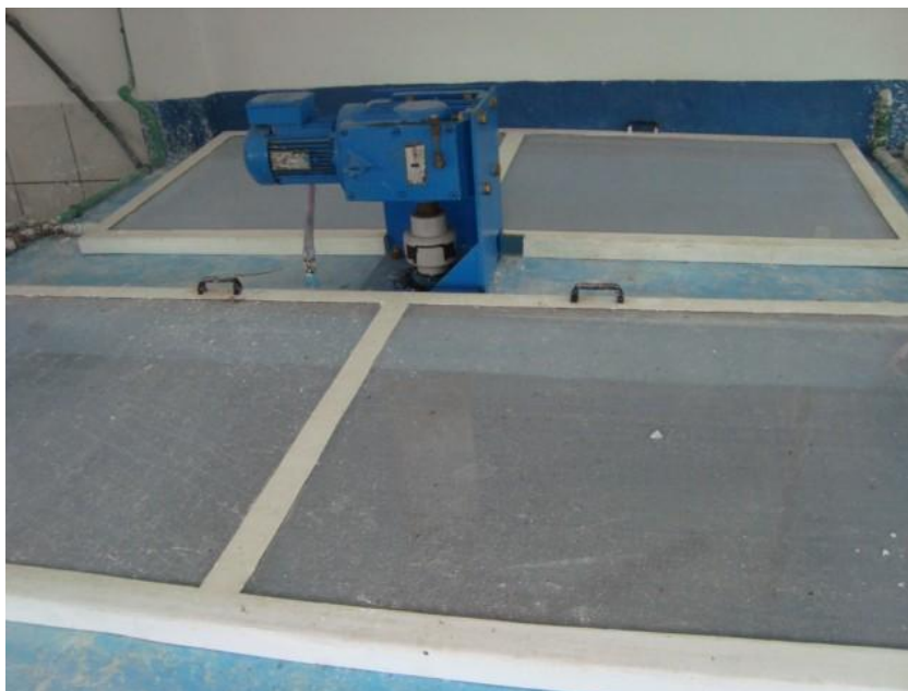
Foto 12 - Tinas de dosagem de produtos químicos
