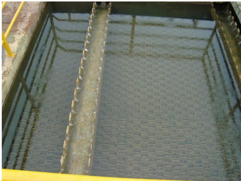
Foto 9 - Etapa de floculação/decantação
