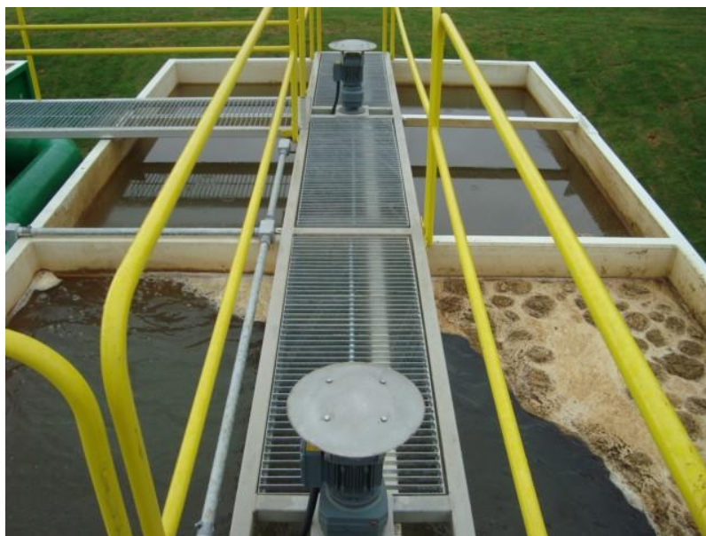
Foto 7 – Etapa de coagulação (ETA compacta)
