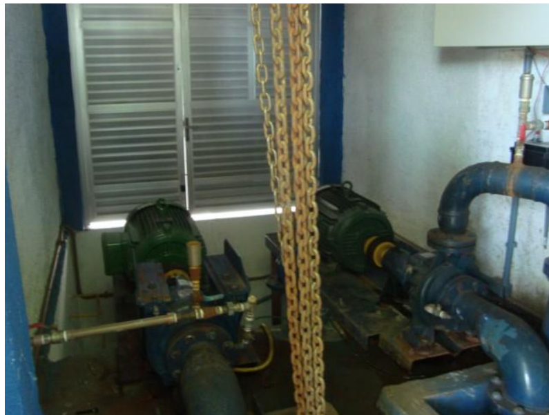
Foto 17 - EEAT Quintino Bocaiúva (motobombas)
