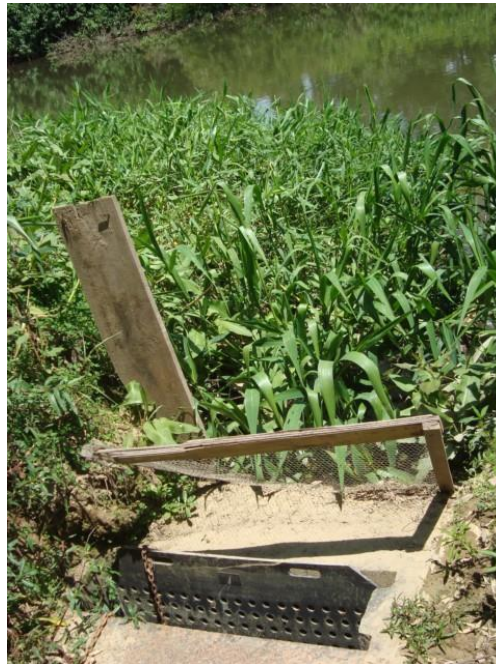
Foto 2 - Grade de Captação
