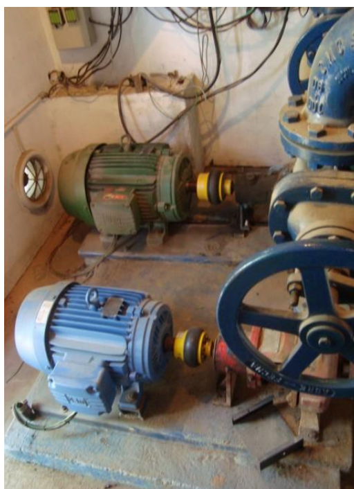
Foto 15 - EEAT R. Blumenau (motobombas)
