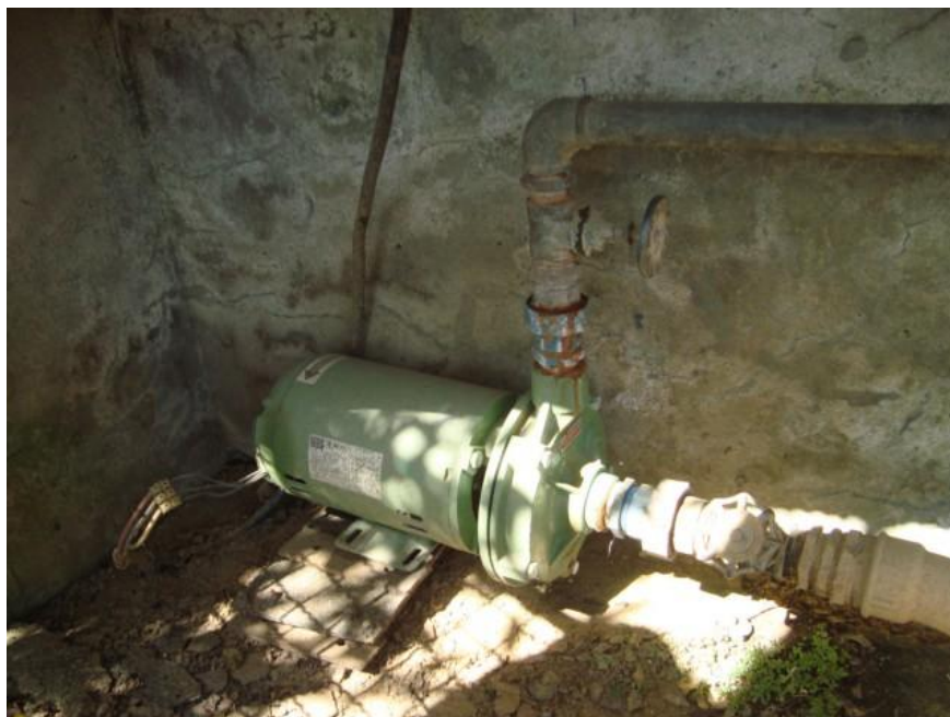
Foto 28 - Booster R. Alfredo Hansen (motobomba)
