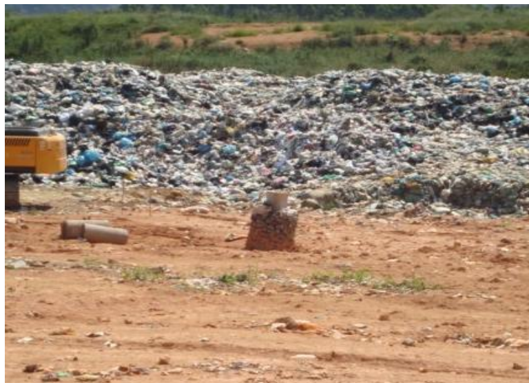
Foto 58 - Drenos de gás
