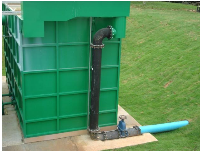
Foto 6 - Tubulação de entrada de água bruta
