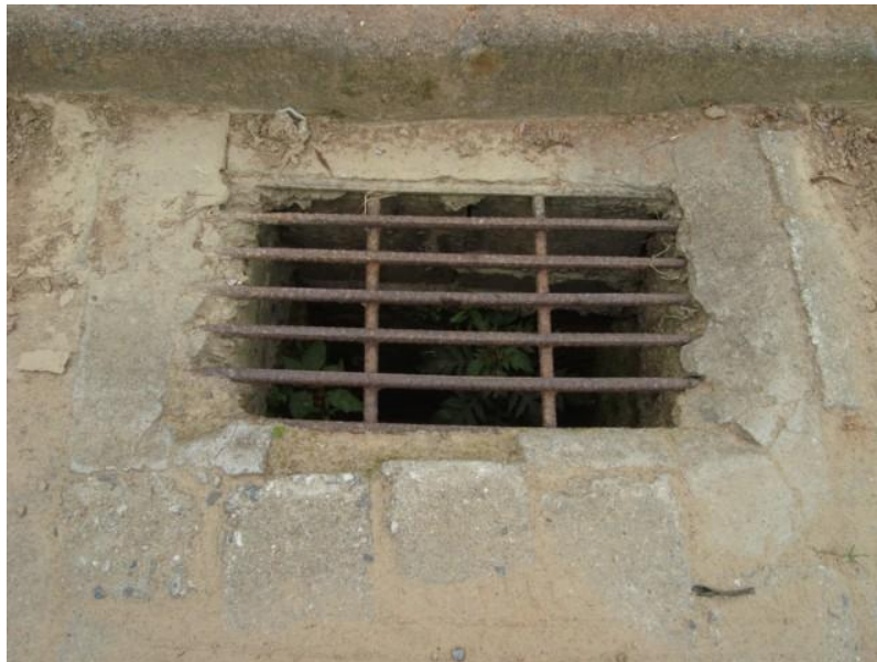
Foto 61 - Exemplo de boca coletora
