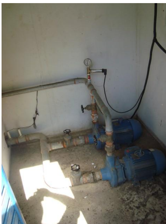
Foto 31 - Booster Guabiruba (motobombas)
