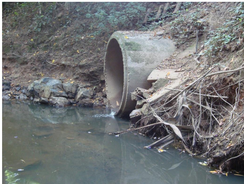
Foto 42 - Tubo coletor de drenagem/esgoto em Timbó
