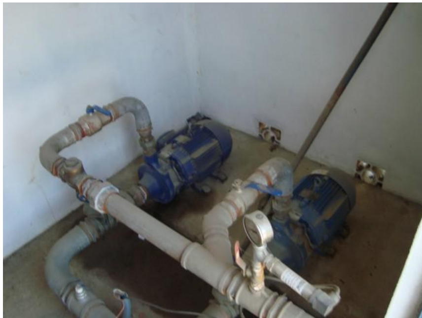
Foto 26 - Booster Quintino Bocaiúva (motobombas)
