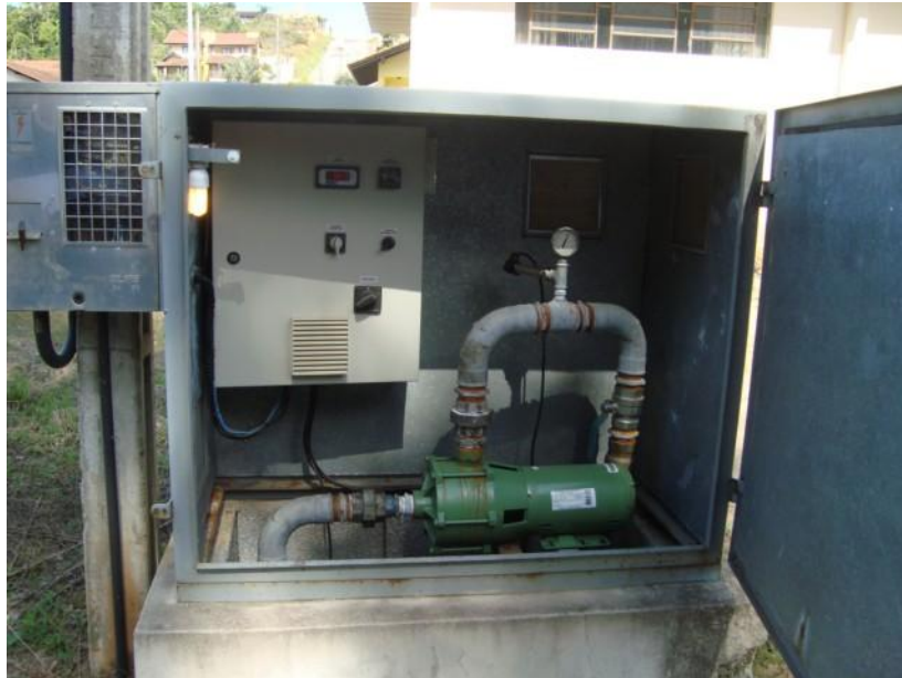
Foto 34 - Booster Rua São Carlos
